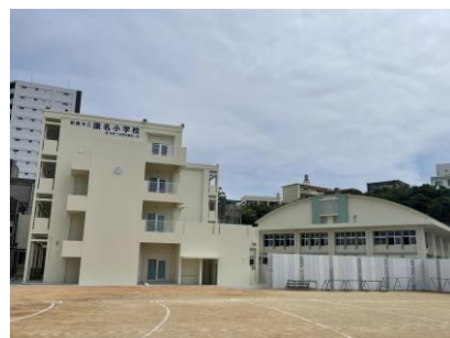
新しくなった校舎と体育館 体育館の隣にプールを建築中 プールは8月頃に完成予定
